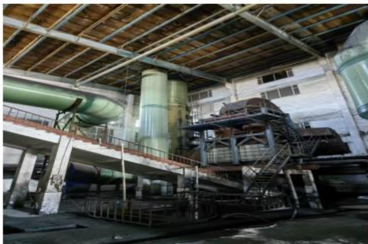
现有湿式脱硫除尘器
